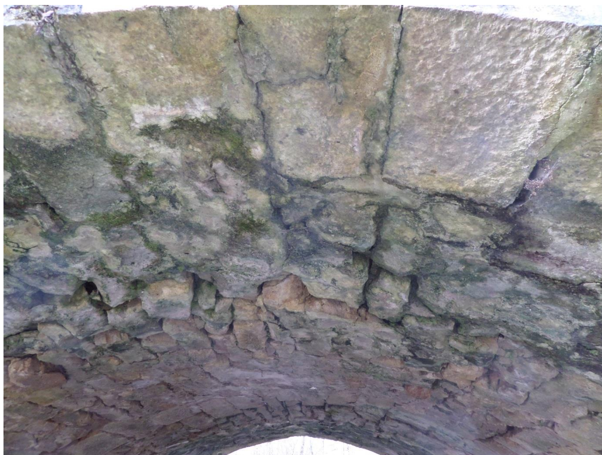
Déchaussement très important des moellons de la voûte
