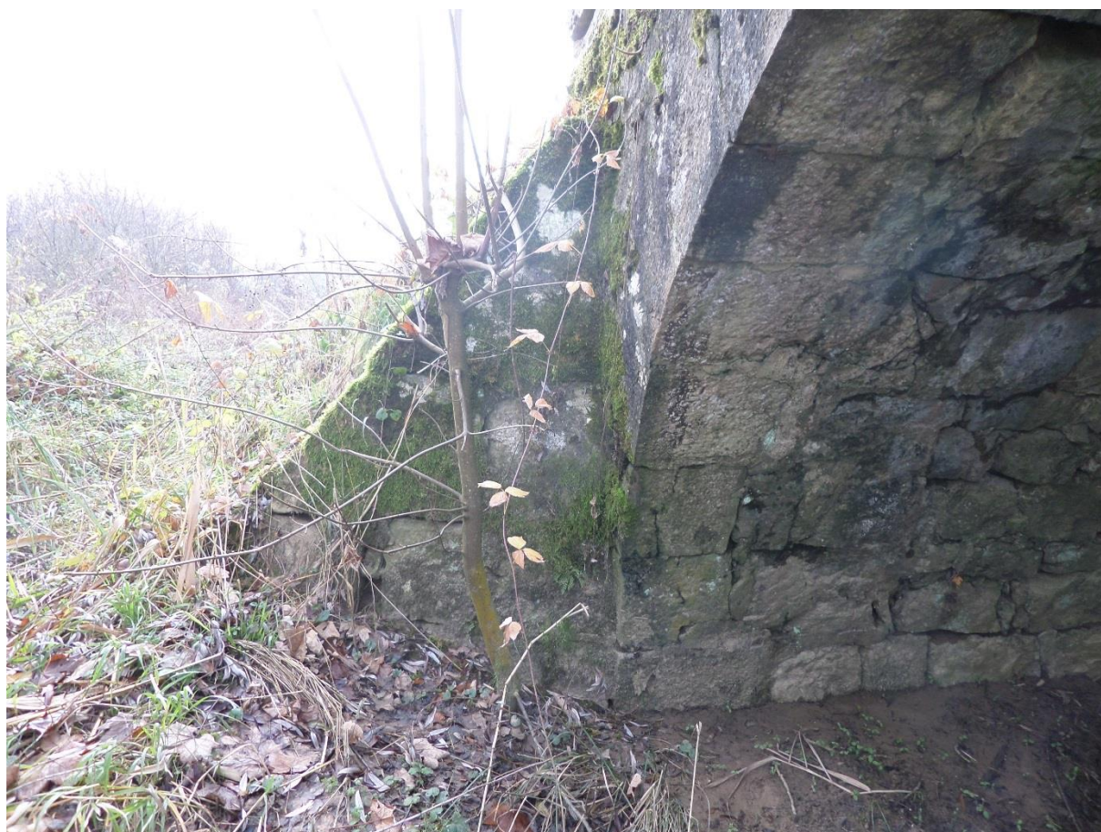
Déchaussement des pierres du mur en retour amont RG
