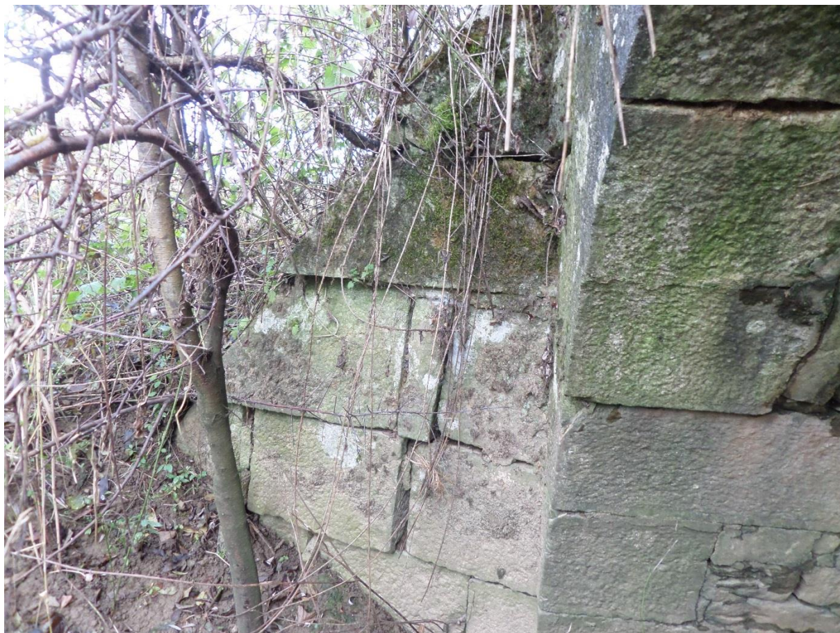
Déchaussement des pierres du mur en retour aval RD
