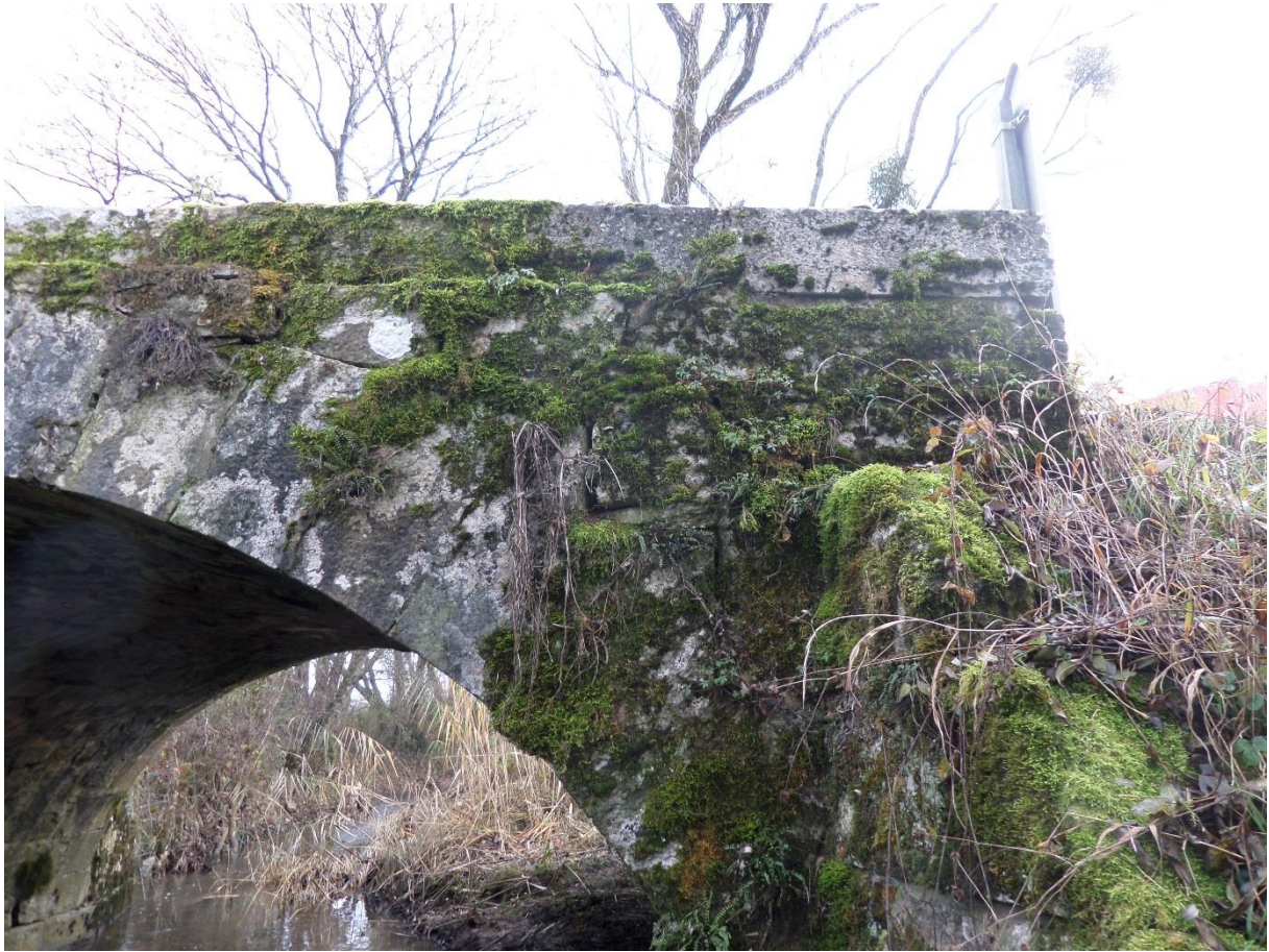
Bombement sur le tympan aval RG
