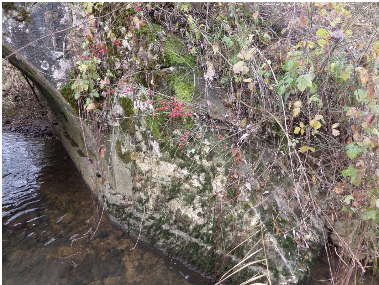
Déchaussement des pierres du mur en retour amont RD
