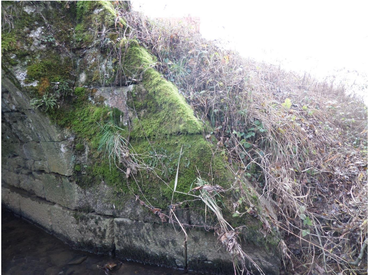
Déchaussement des pierres du mur en retour aval RG
