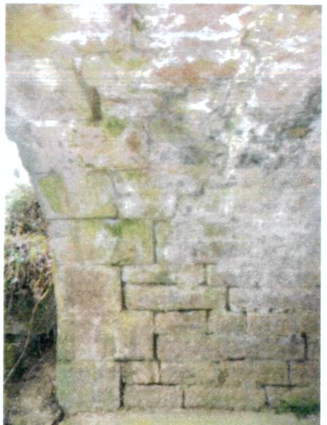
Bandeau aval / RD : décollement du bandeau
