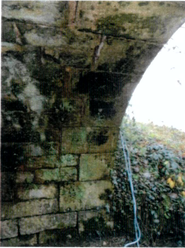
Bandeau amont / RD : décollement du bandeau
