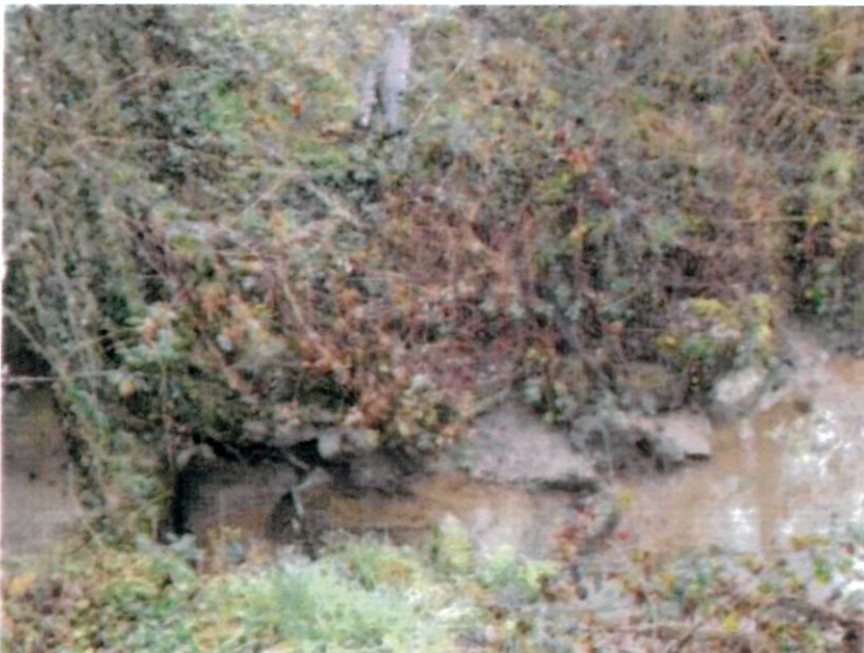
Talus aval / rive gauche : effondrement des enrochements
