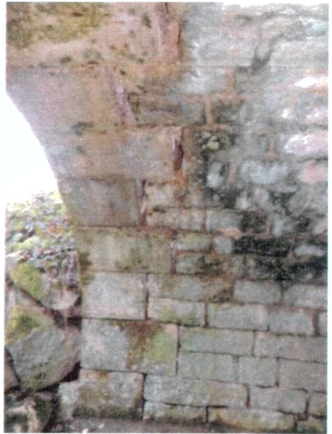
Bandeau amont / RD : décollement du bandeau
