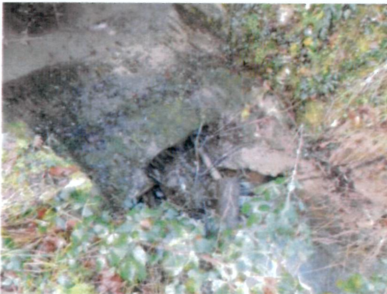
vue côté amont : présence de 2 buses Ø400 mm intégrées dans le bétonnage du radier, qui repose sur des enrochements
