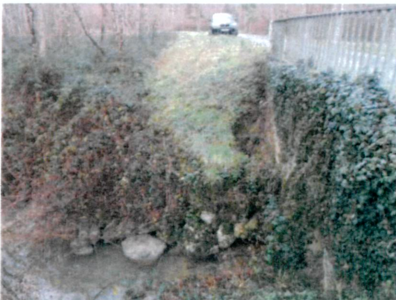
Talus aval / rive droite : effondrement des enrochements et du talus
