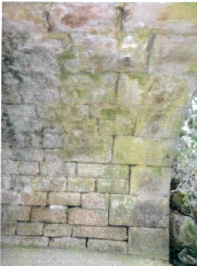
Bandeau aval / RG : décollement du bandeau
