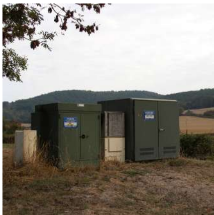
Ce poste de transformation électrique comme posé au bord de la route
