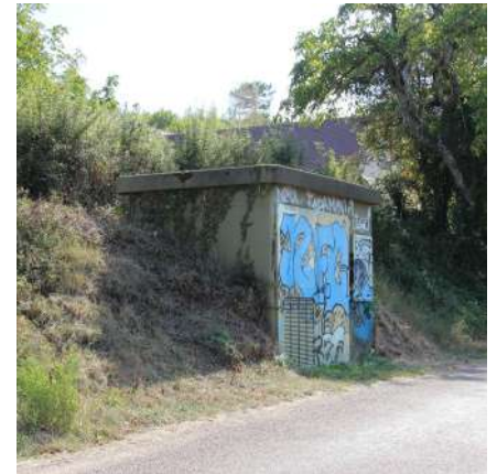
Ce poste de transformation électrique utilise la topographie pour s'intégrer
