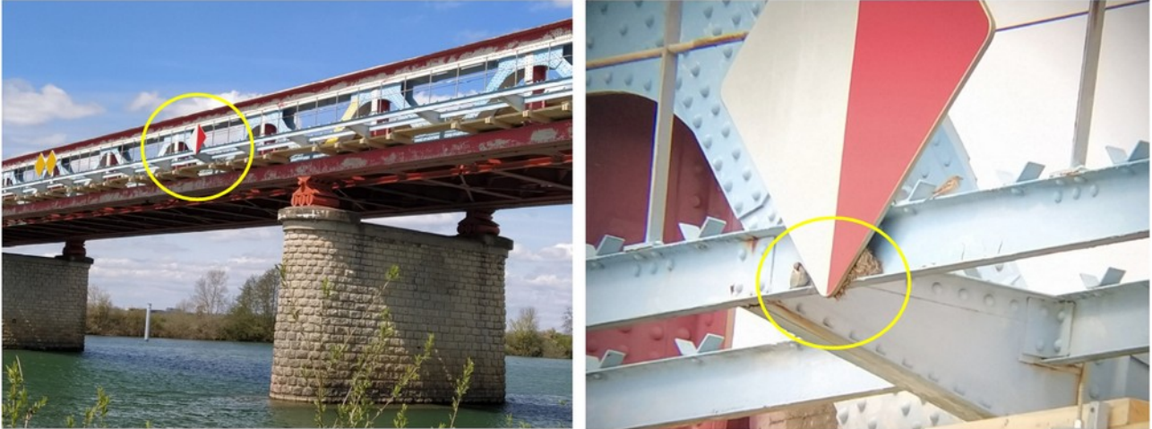
Figure 7 : Localisation d'un nid de Moineau domestique sur l'ouvrage. Le panneau concerné se situe sur la partie latérale du pont côté aval, entre la 1 ère et la 2 ème pile.
