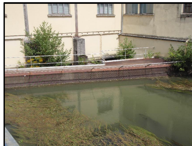
Photographie n° 16 : vue des grilles de protection de la station de pompage
