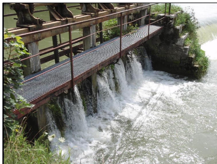
Photographie n° 5 : vue des vannes de décharge en rive droite du seuil de prise d'eau
