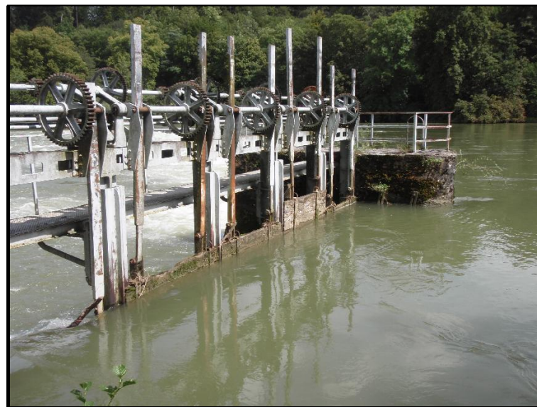
Photographie n° 3 : vue amont des vannes de décharge en rive gauche du seuil de prise d'eau
