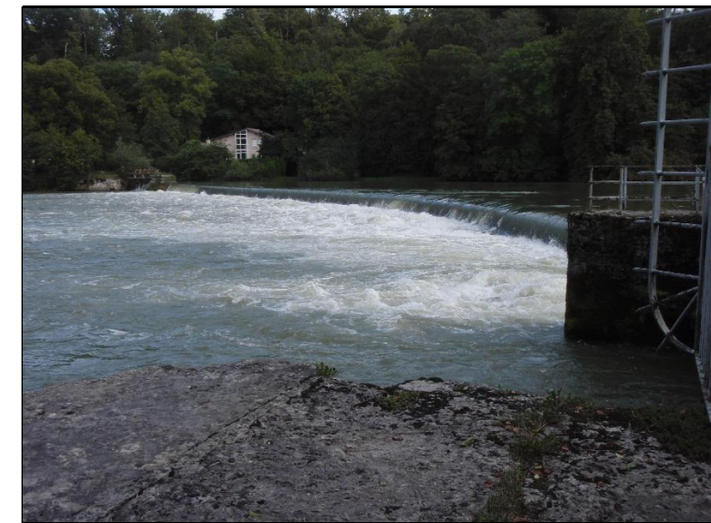
Photographie n° 2 : vue du seuil de prise d'eau, depuis la rive gauche, et de ses vannages de décharge en rive droite et gauche
