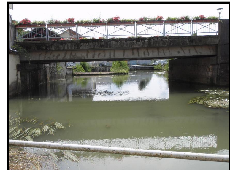
Photographie n° 17 : vue amont de la station de pompage avec au fond la zone d'alimentation du canal souterrain
