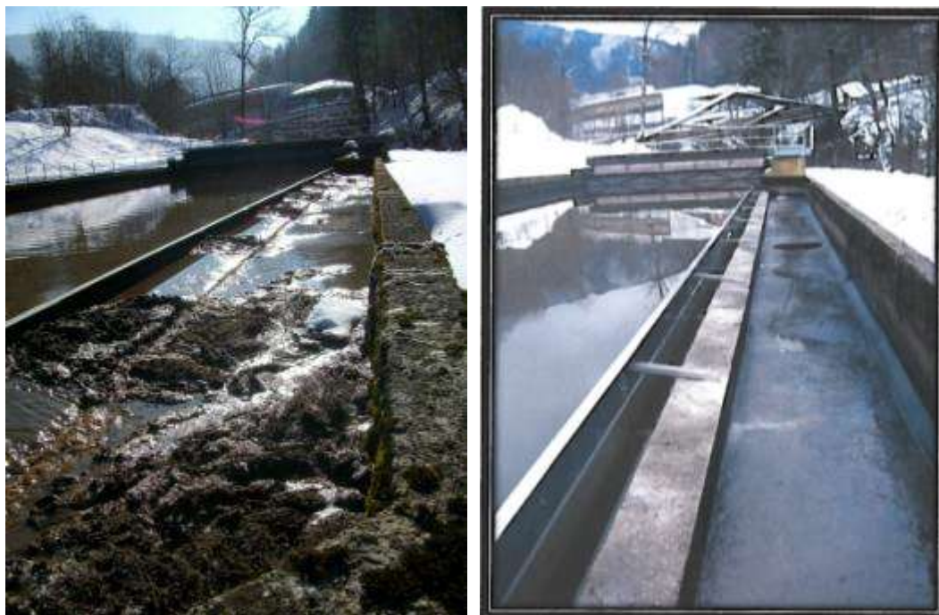
Fig. 22. Ouvrage de dégazage en fonctionnement et lors d'une opération de maintenance
