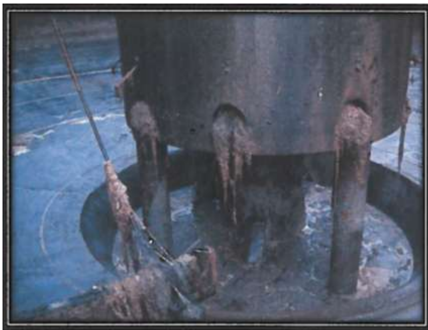
Fig. 23. Bouchage des ouïes du clarificateur (Source SOGEDO)
