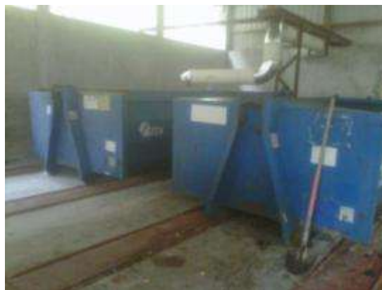
Fig. 30. Bennes de stockage des boues déshydratées
