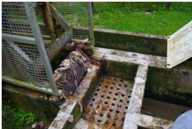
Fig. 17. Récupération des déchets de grille
