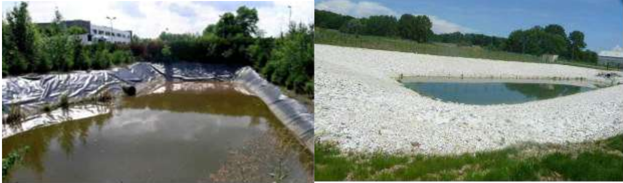
Exemples de bassins de récupération des eaux pluviales inadaptés au développement de la faune
