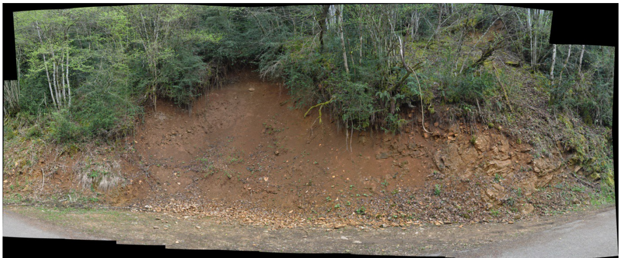
Talus amont de la route de Villette à Turgon
