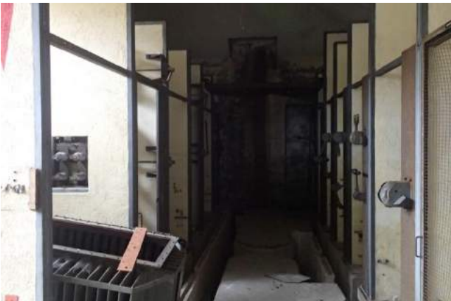
Vue de l'intérieur de la centrale électrique (aucune trace d'utilisation)
