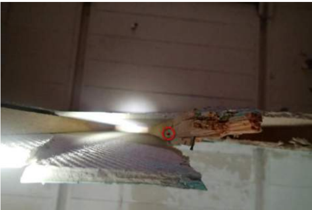
Double cloison délabrée occasionnellement utilisée vue par en dessous, le cercle rouge localise une crotte de chauve-souris (a priori Pipistrelle sp.)
