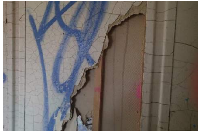
Double cloison délabrée occasionnellement utilisée par les chauves-souris (a priori Pipistrelle sp.)
