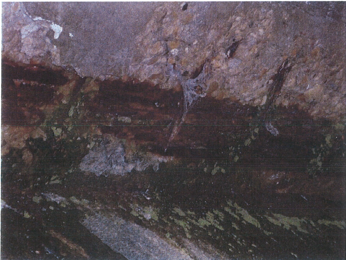
Ph. 22 Détail des dégradations
