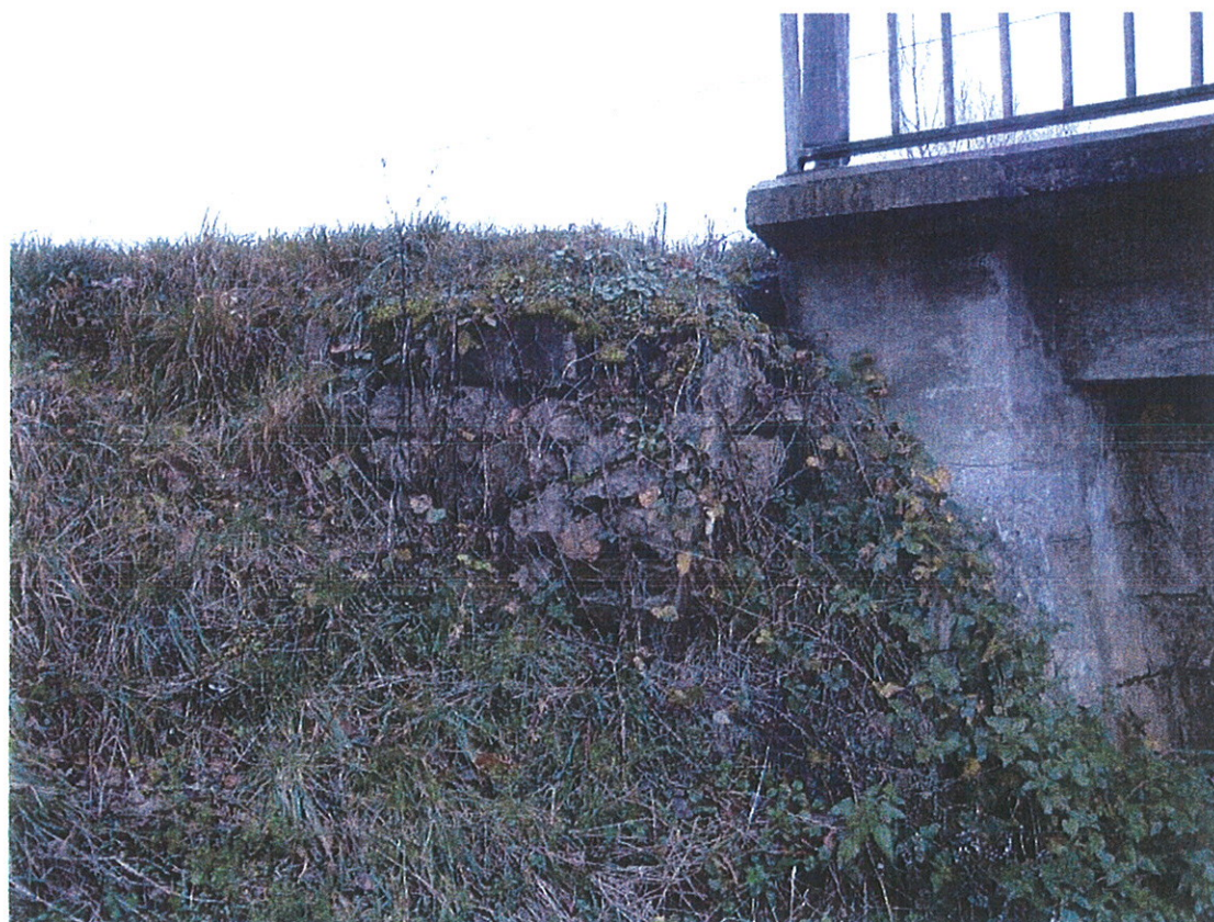
Ph.16 Gabions instables au droit du mur en aile aval R.D.
