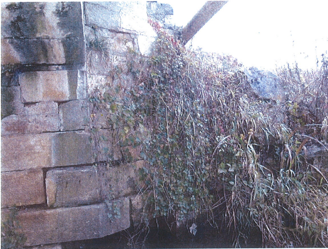
Ph.9 Mur en aile amont R.D. disjointoiment et fissure verticale
