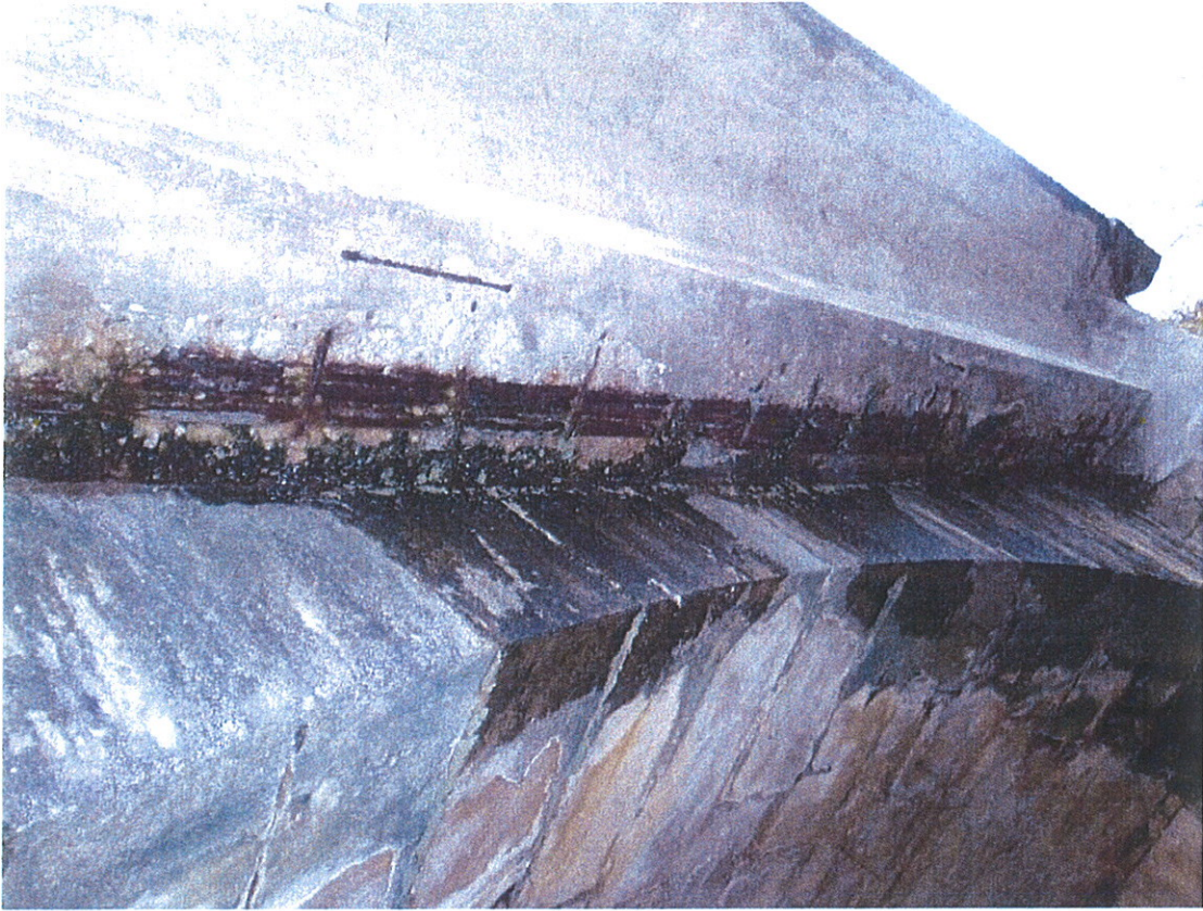
Ph. 21 Béton dégradé et aciers apparents sous élargissement aval
