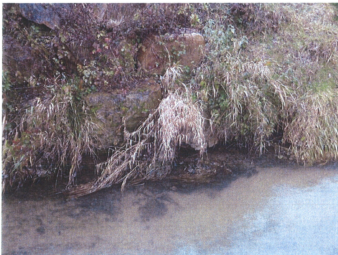
Ph.12 Affouillement sous 1/4 de cône amont R.D.
