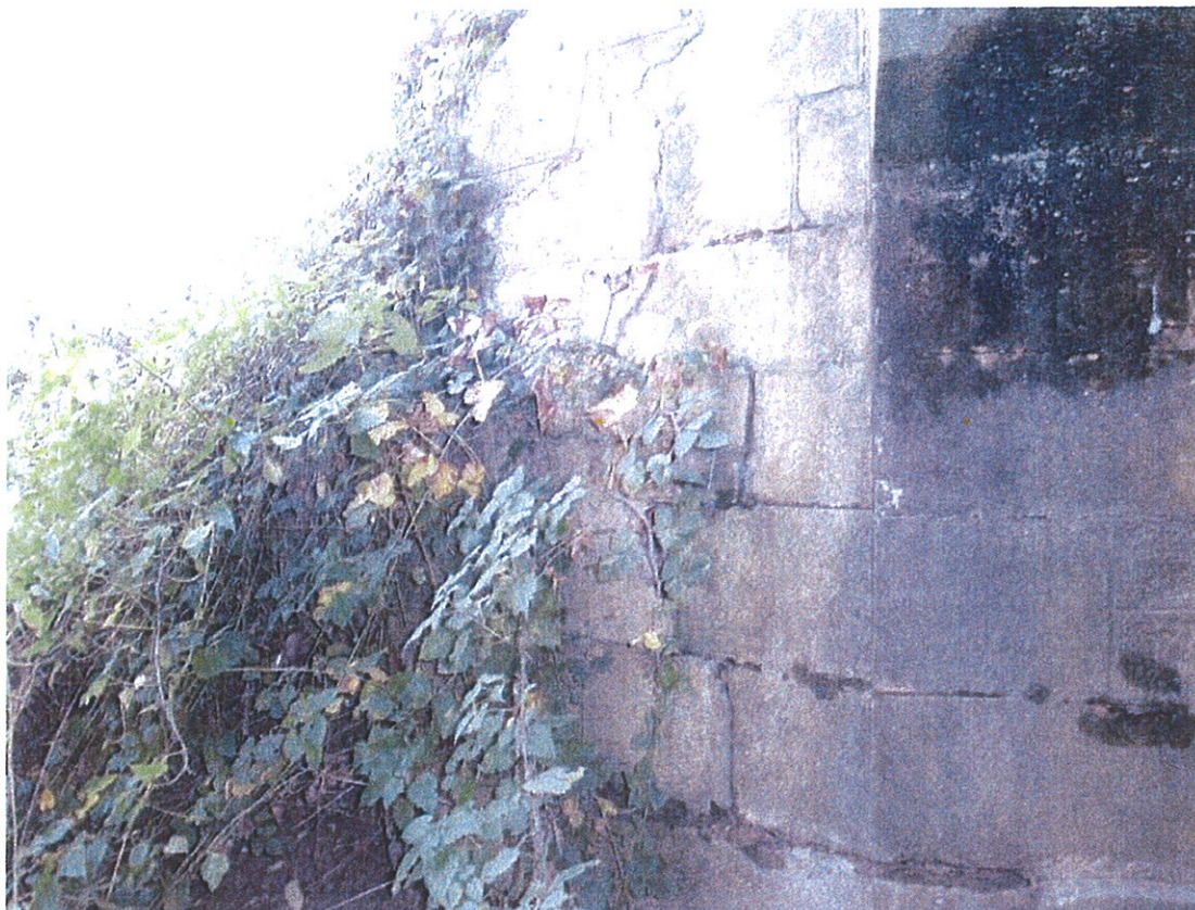
Ph.15 Mur en aile aval R.D. fissure verticale
