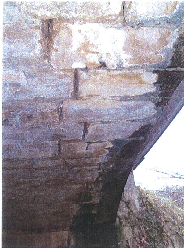
Ph.29 Décollement bandeau amont Côté R.D.
