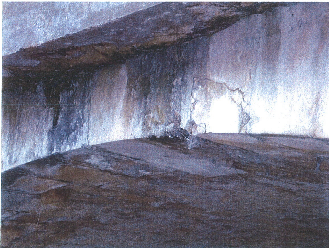
Ph. 26 Un moellon éclaté sur bandeau de voûte côté amont
