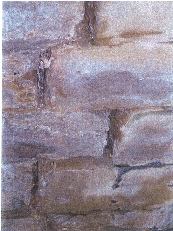
Ph.30 Détail du décollement de bandeau
