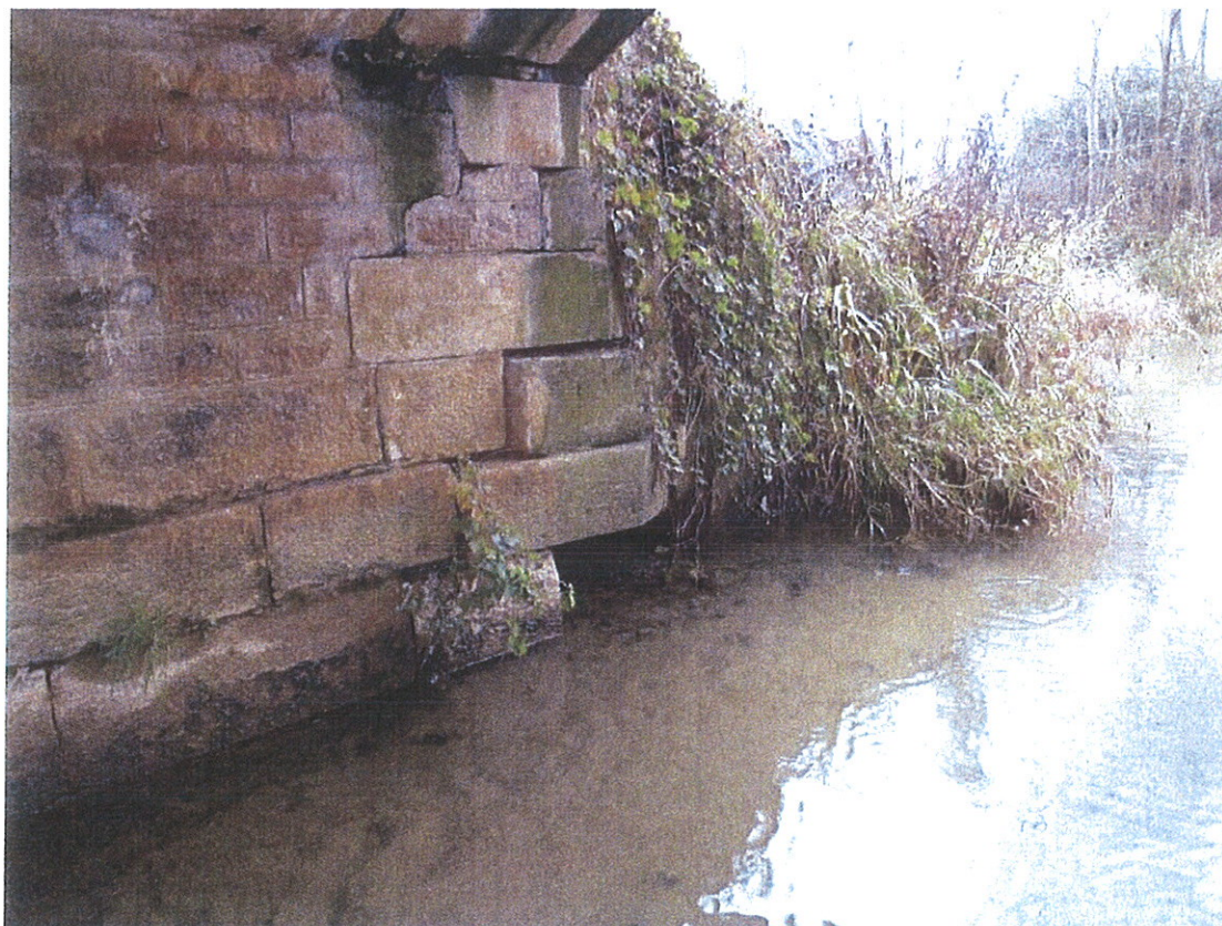
Ph. 32 Evidement en pied de piédroit amont R.D. et déstabilisation de la chaîne d'angle
