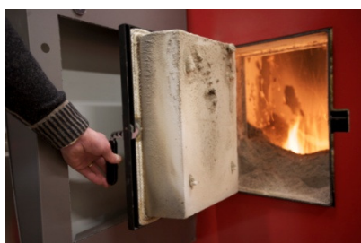
Chaufferie bois à Saint-Seine-l'Abbaye
