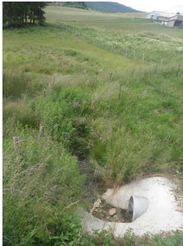
Rejet réseau pluvial des Chauvins
