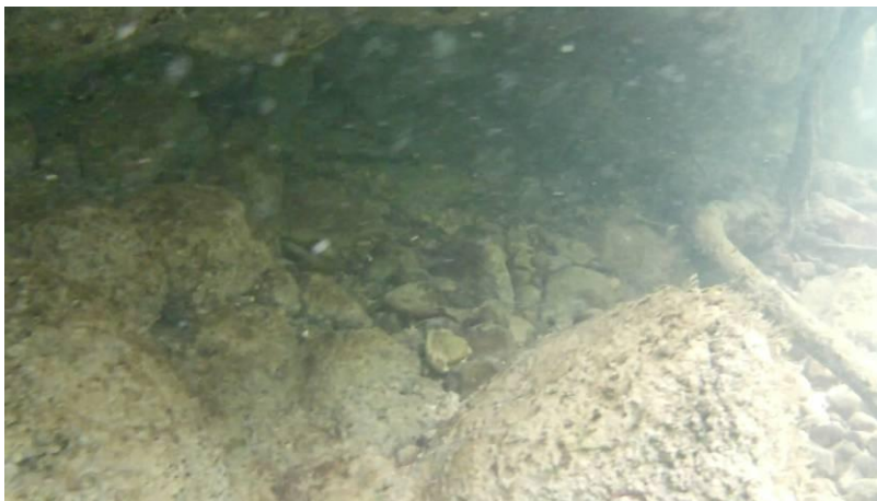
Vue sous l'affouillement à l'aval du seuil
