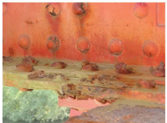
Ph.44 Travée 2, entretoise E12 : détail de la corrosion
