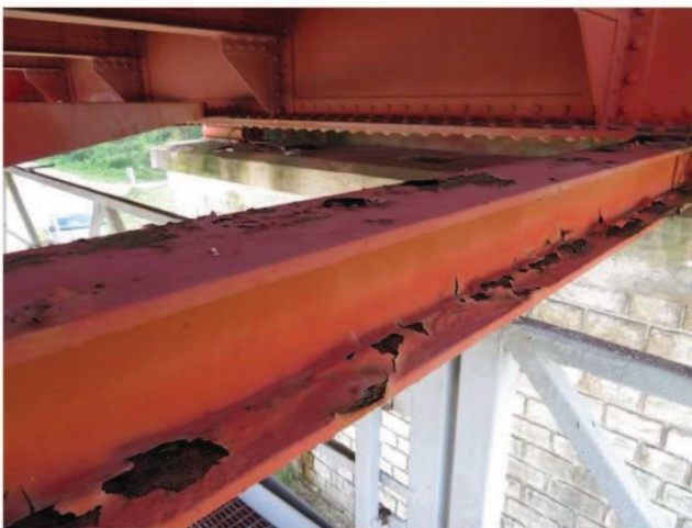
Ph.39 Travée 1, longeron n°4 : corrosion et écaillage de la peinture
