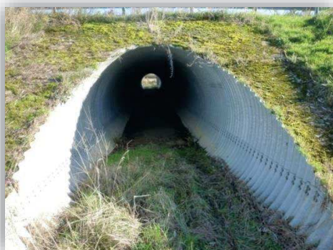
Figure 39 : Passage entre le point 1 et l'aire de St Pierre. Pour ce cas le sol en béton devrait être remplacé par un substrat plus naturel
