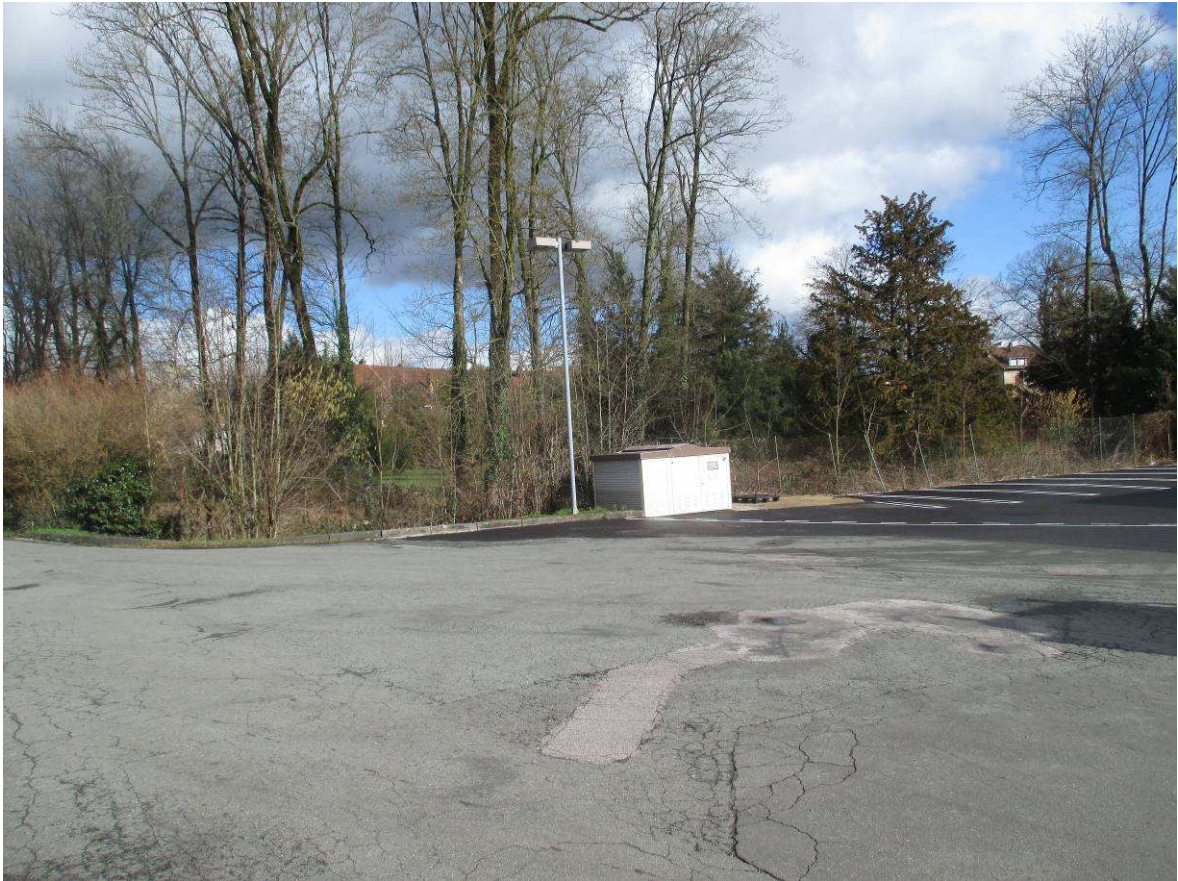
Transformateur au Nord du site avec zone inondable en contre bas
