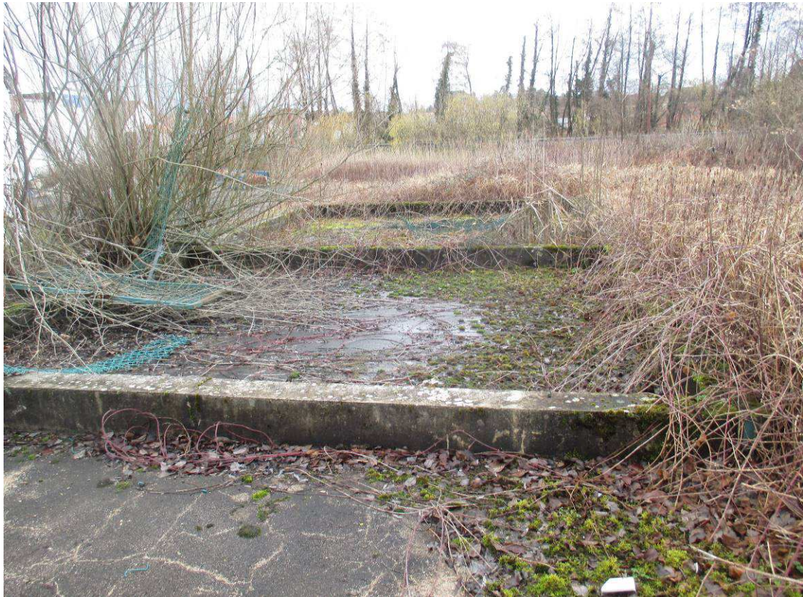
Installation au Sud du site en sortie des ateliers.
