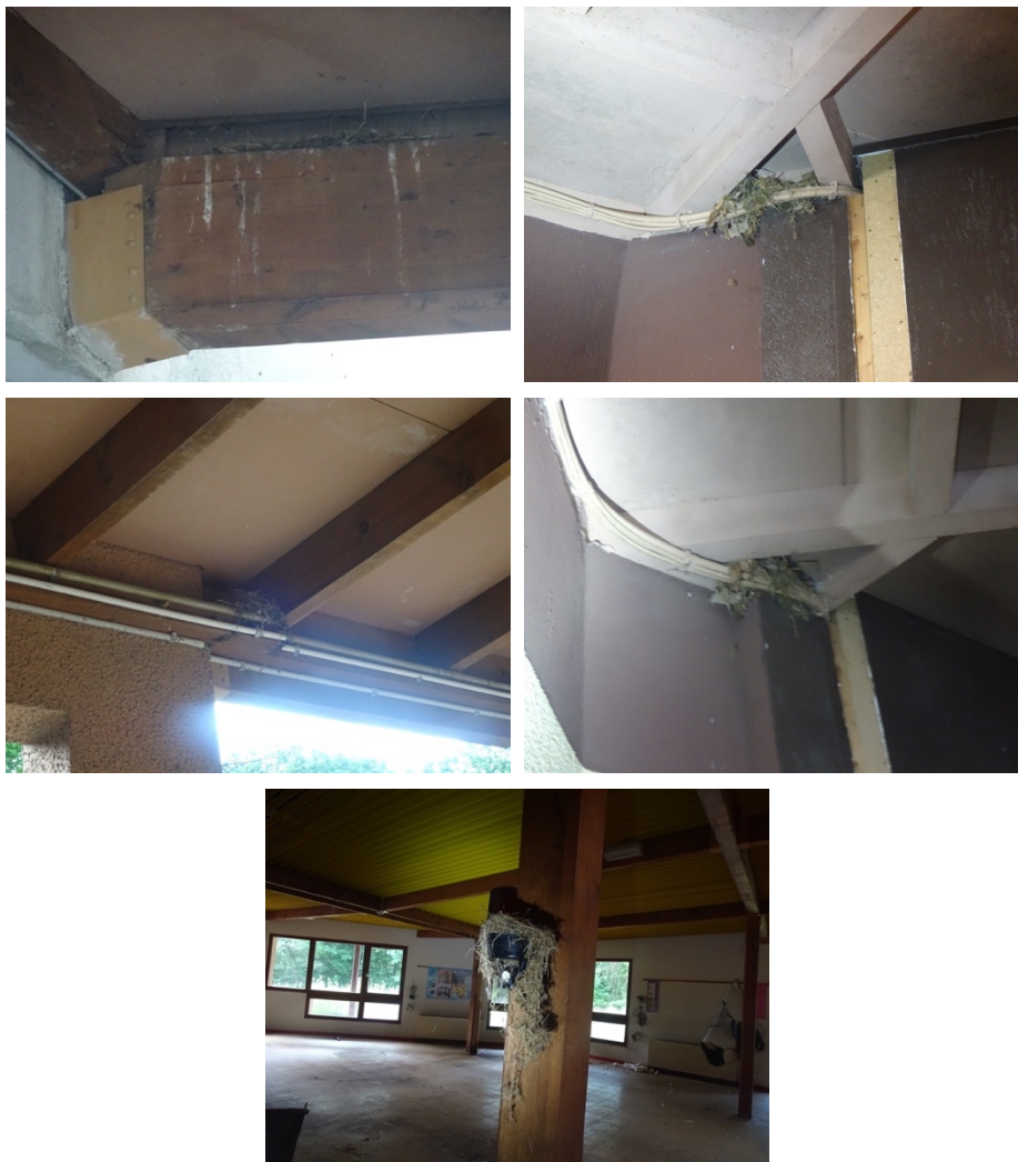
Figure 10 : Anciens nids de Rougequeue noir observés sur l'Aile nord et le bâtiment central
