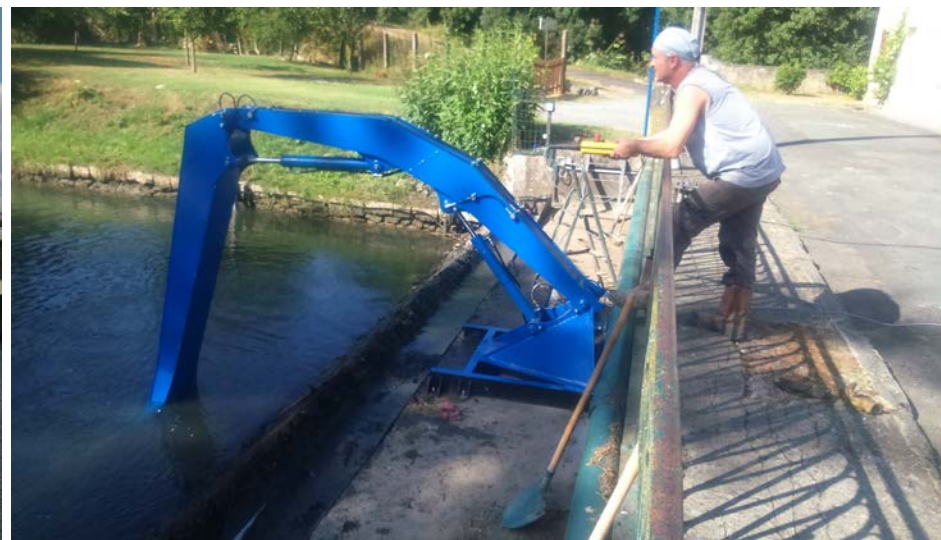
Mise en place d'un dégrilleur spécifique aux prises d'eau ichtyocompatibles
