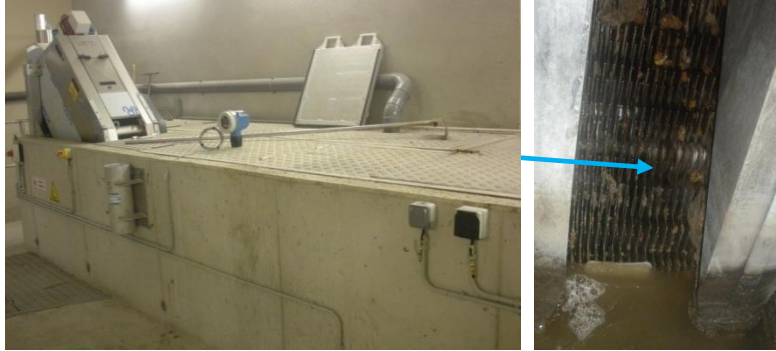
Photographies du dégrilleur de la STEP
