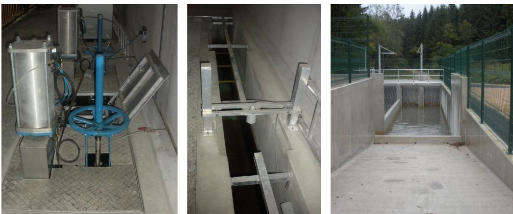
Photographies de la bache d'eaux traitées, du canal de sortie et du dégrilleur
