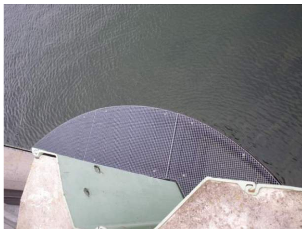
Fig. 21. Pare-embâcles en entrée de passe à poissons
