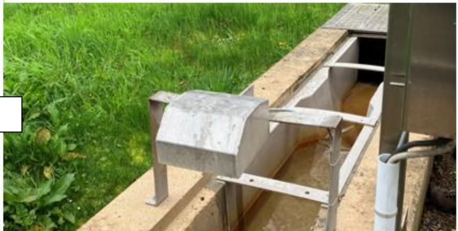
Canal de sortie
