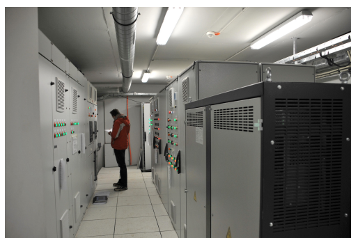
La gestion technique centralisée (GTC) du tunnel - Crédits J.REVON
