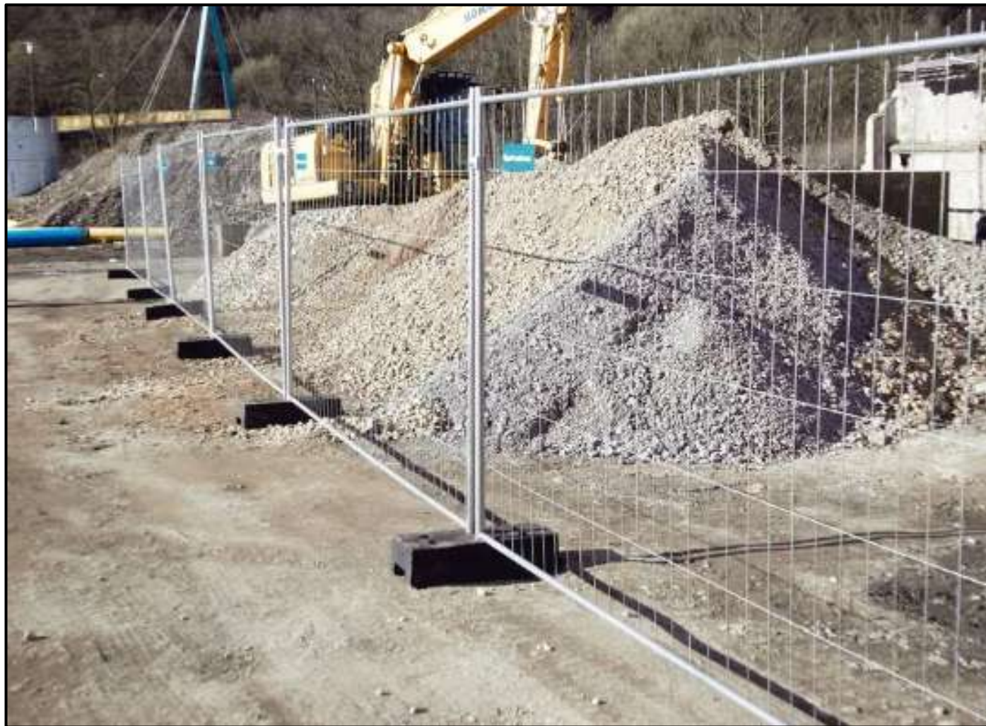
Figure 72 : Exemple de barrières temporaires
