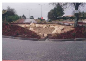
Photo 8 : Puits d'infiltration (Copyright : Siba)
