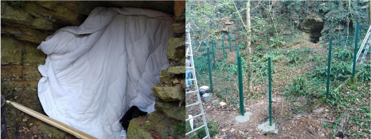
Figure 9 : Installation définitif du nouveau grillage sur la mine d'Ougney-Vitreux novembre 2022 et fermeture de la cavité durant la phase travaux (CPEPESC FC, 2022)
