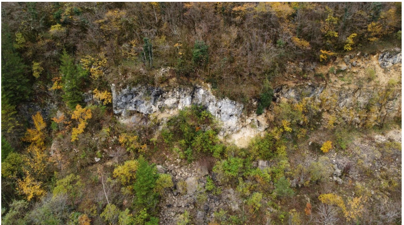
Figure 25 : Falaise à sécuriser prise à partir d'un drone en rive droite de l'Ain, portion amont présentant des fissures et des cavités dans la partie haute mais avec des chutes de gros blocs rendant dangereuses les prospections
