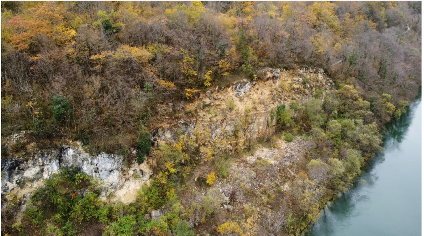
Figure 24 : Falaise à sécuriser prise à partir d'un drone en rive droite de l'Ain, portion amont s'éboulant, notamment la partie haute rendant impossible toute prospection, partie basse présentant quelques fissures
