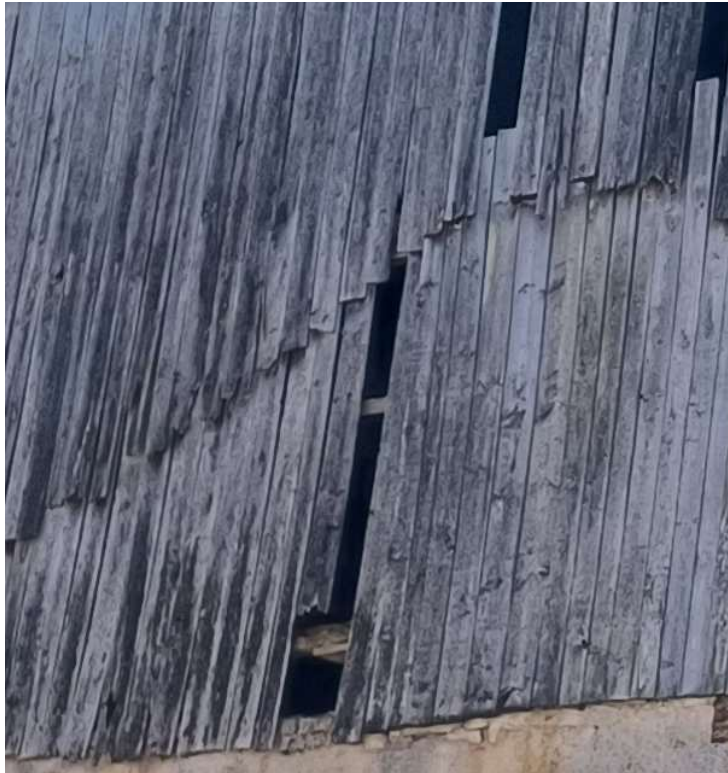
Figure 8: Bardage bois avec décollement
