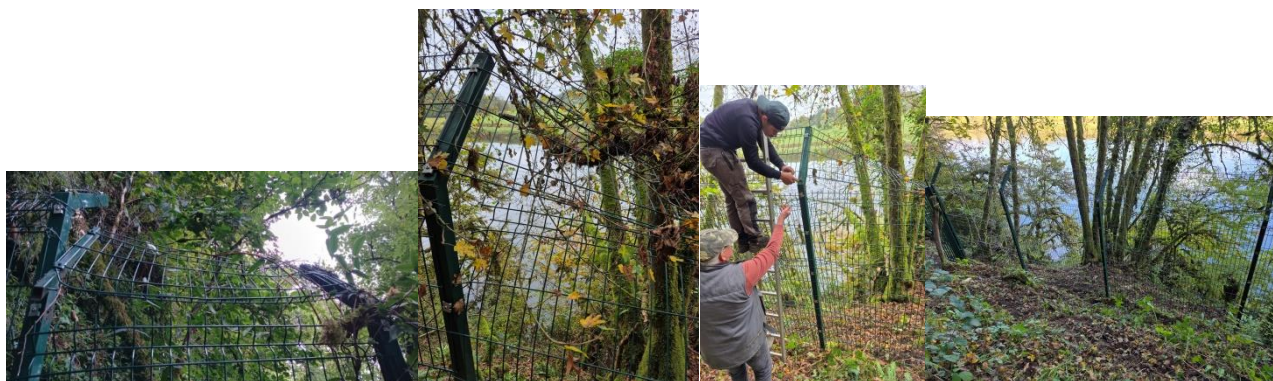
Figure 6 : De Gauche à droite, Dégradation Grillage 2024, Dégradation Grillage 2025, Réparation 2025, Grillage Réparé 2025. CPEPESC FC, 2024, 2025.
