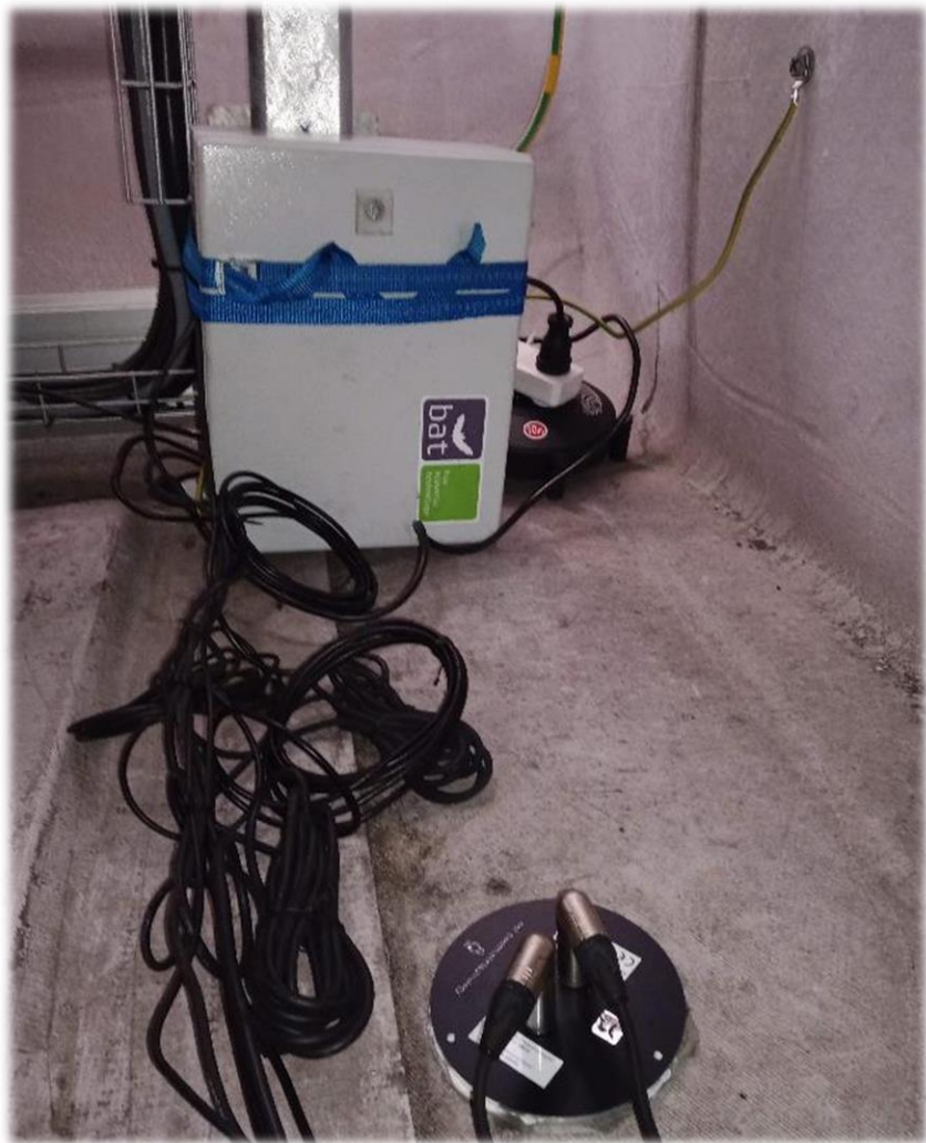
L’éolienne Quin2 a été équipée d’un Batmode S+ (G. Marchais – Écosphère)
