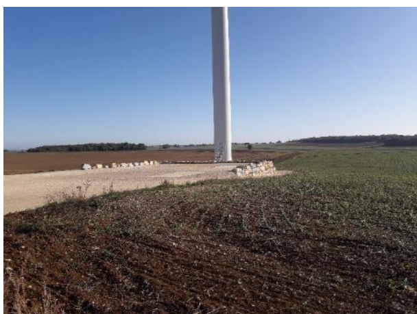
Figure 1 : Éolienne 1 le 10 octobre 2019
