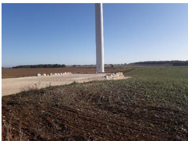
Figure 1 : Éolienne 1 le 10 octobre 2019
