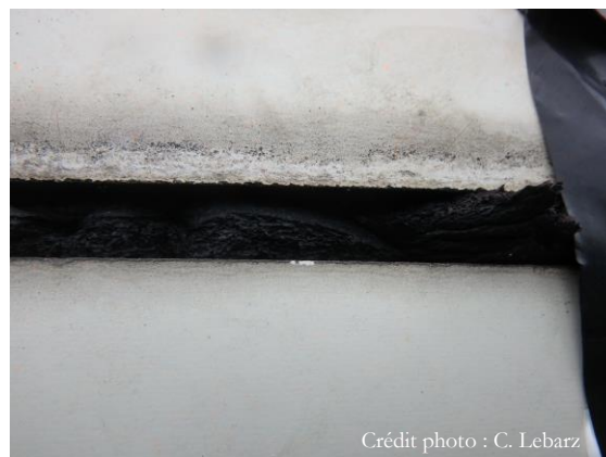
Figure 15 : Exemple de condamnation avec des « boudin » de mousse d'isolation de tuyau de chauffage
