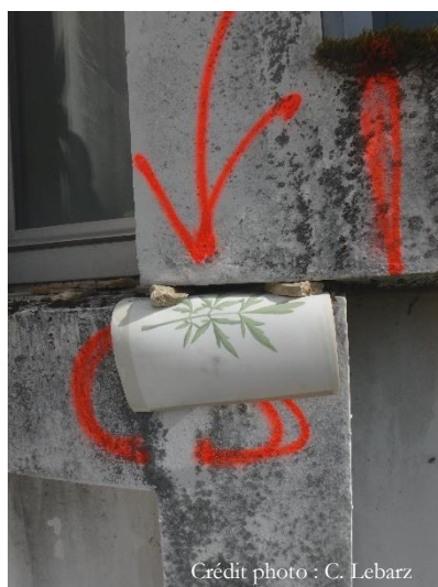
Figure 16 : Exemple de système anti-retour en fissure horizontale
