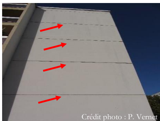
Figure 10 : Joints de dilatation potentiellement favorables aux chiroptères
