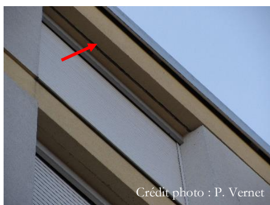
Figure 11 : Exemple de disjointement
