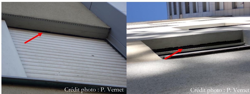
Figure 12 : Espace libre entre le coffrage du volet roulant et la maçonnerie
