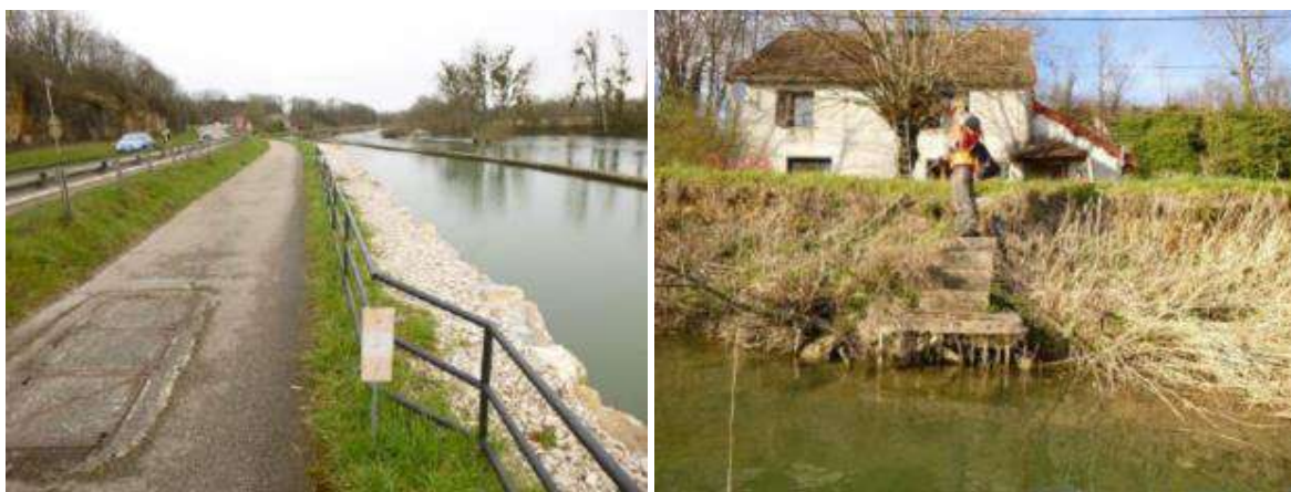
Figure 25. Etat général du garde-corps (PM644 au PM698) et de l'escalier d'accès au canal (PM226)
