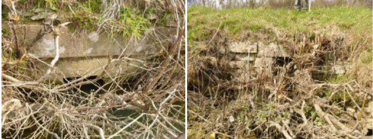
Figure 24. Etat général des aqueducs au PM69 (à gauche) et au PM566 (à droite)
