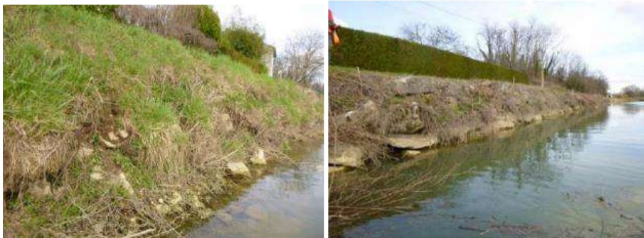
Figure 21. Etat général des enrochements de faibles dimensions (à gauche) et de grosses dimensions (à droite)
