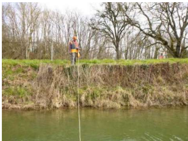
Figure 20. Etat général du rideau de palplanches
