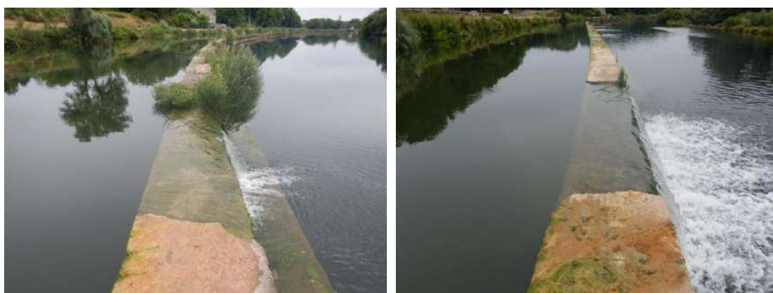
Figure 12. Exemples de désordres de gravité 3 - Eclatements prononcés du béton de surface avec surverse
