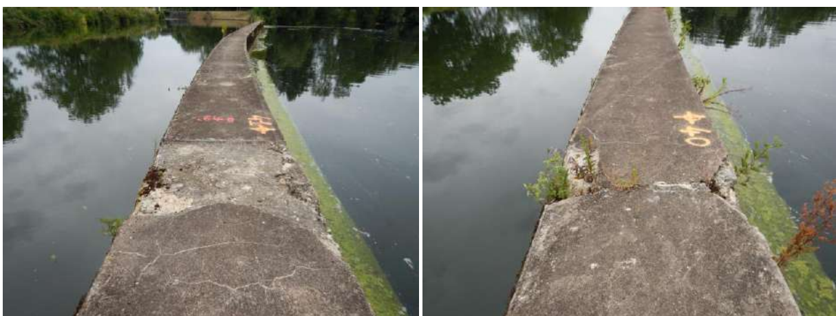
Figure 10. Exemples de désordres de gravité 1 - Ecaillage (à gauche) et épaufrures/fracture (à droite) du béton de surface
