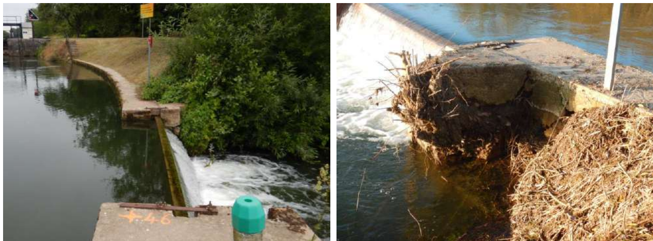
Figure 13. Etat général du déversoir de décharge
