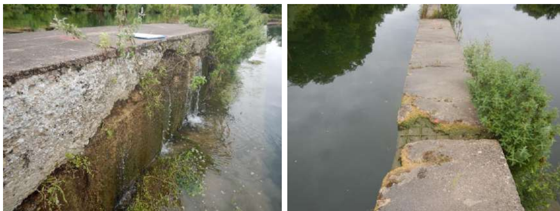
Figure 11. Exemples de désordres de gravité 2 - Altération du béton et Infiltrations d'eau ponctuelles (à gauche) et fers apparents en surface (à droite)
