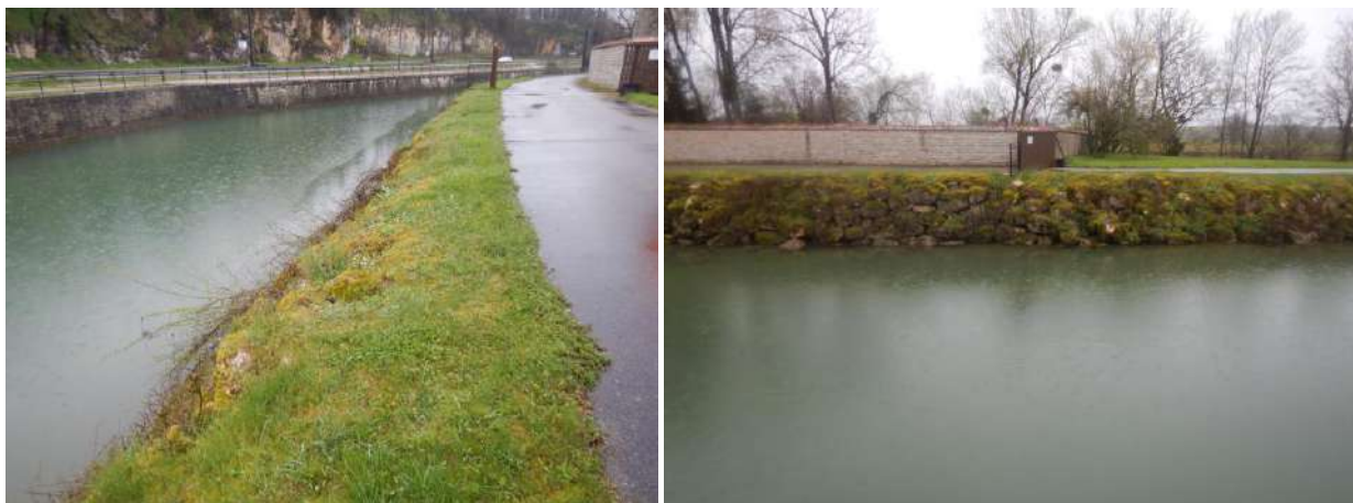
Figure 8. Morphologie de la berge en amont rive gauche de l'écluse n°62
