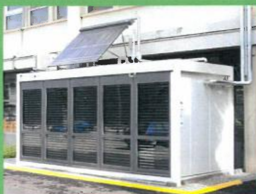
Des capteurs solaires en toiture et sur le vitrage produisent de l'ECS et permettent de se protéger du soleil.
