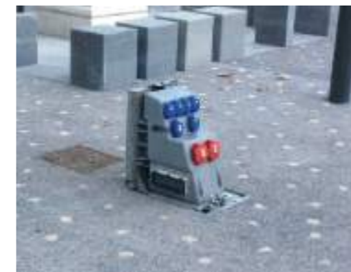
↑ Borne escamotable Eau & électricité
