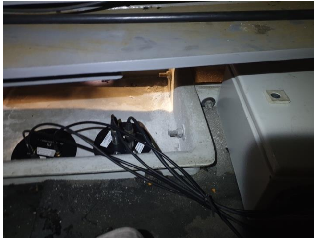
Figure 3 : Exemple de BATmode installé dans une nacelle d'éolienne
