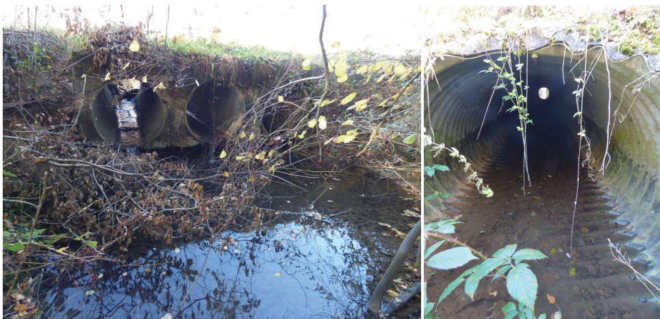
Absence de continuité au déplacement de la faune aquatique au droit de l'ouvrage de franchissement d'un chemin d'exploitation agricole en aval de l'autoroute A6 (à gauche) et absence de lit « naturel » au droit du franchissement de l'autoroute A6 (à droite)
