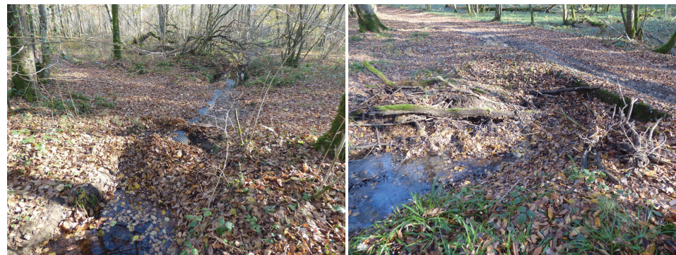
Embâcles et accumulation de matières organiques au niveau de deux ouvrages de franchissement de pistes forestières
