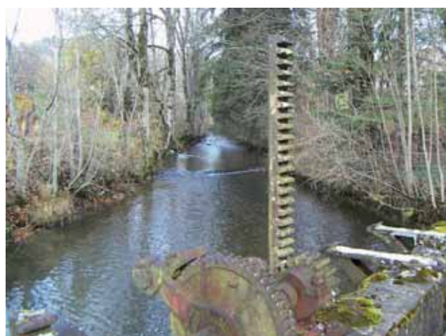
Vanne sur la Jougnena à La Ferrière-sous-Jougne (25)
