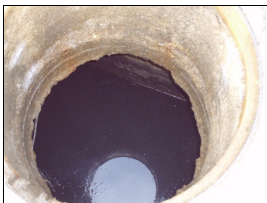
Figure 8 : Photo du décanteur
