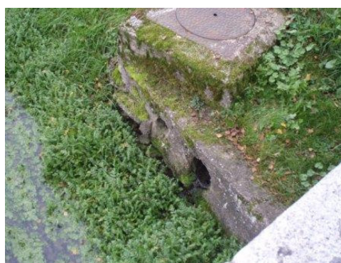
Figure 9 : Exutoire du collecteur d'eaux de pluie de la rue de Noidans
