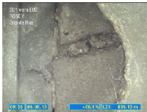
Figure 8 : Effondrement partiel de la canalisation
