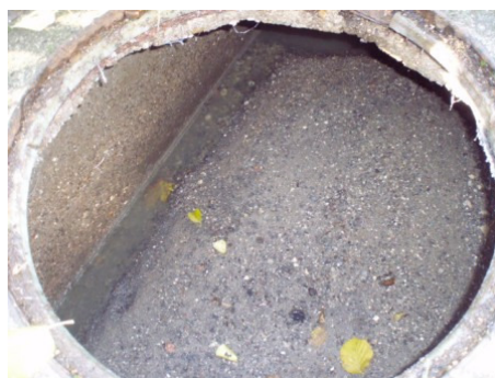
Figure 9 : Photo de la fosse de décantation
