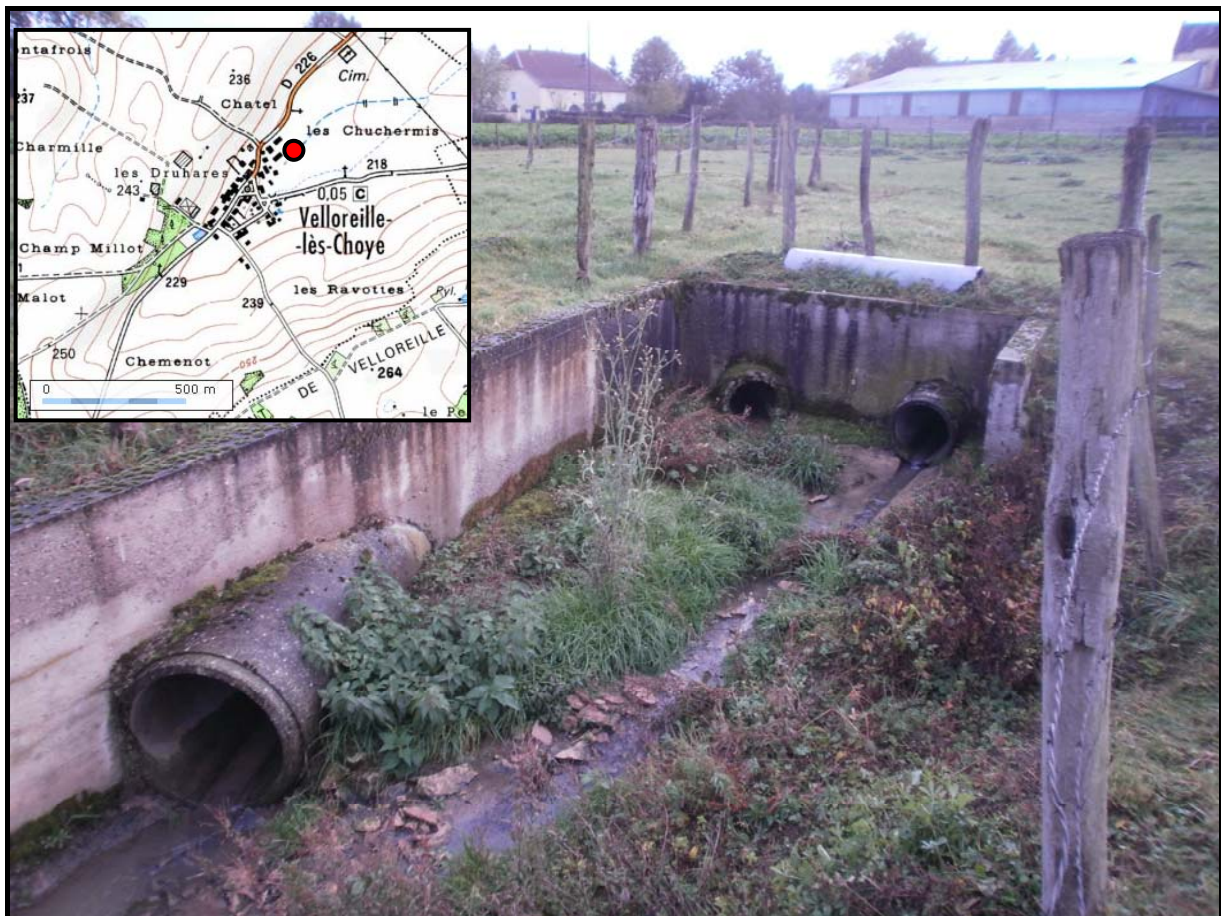
Exutoire du réseau pluvial de la commune de Velloreille-les-Choye
