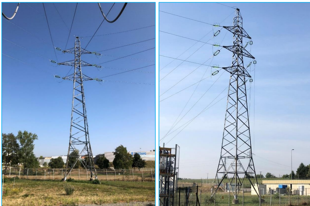
Photographie 1 - Photos d'une entrée en coupure (source : Eco-Stratégie, 2019)
