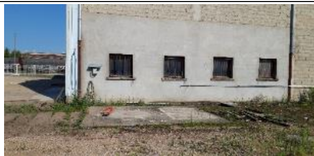
Photographie 4 : Dalle marquée
