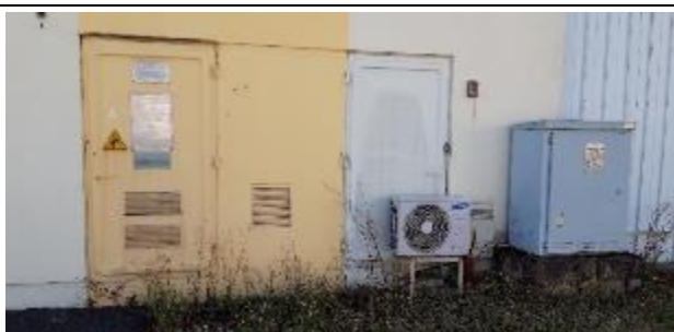
Photographie 7 : Transformateur électrique
