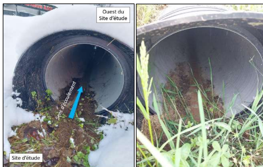
Figure 8 : Photographie de la conduite EP (en date du 18/01/2023 à gauche et du 15/05/2023 à droite) - ECR Environnement
