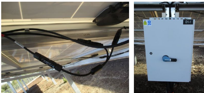
Figure 8 - Exemple de câble électrique et de boîte de raccordement - Q ENERGY France
