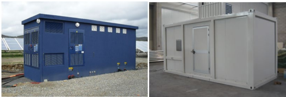
Figure 6- Exemples d'onduleurs et transformateur installés dans postes béton et containers
