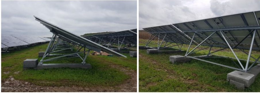
Figure 5- Exemple de fondations béton - Q ENERGY France
