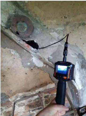
Figure 20 : Vérification d'une cavité à l'endoscope © EODD, 2023
