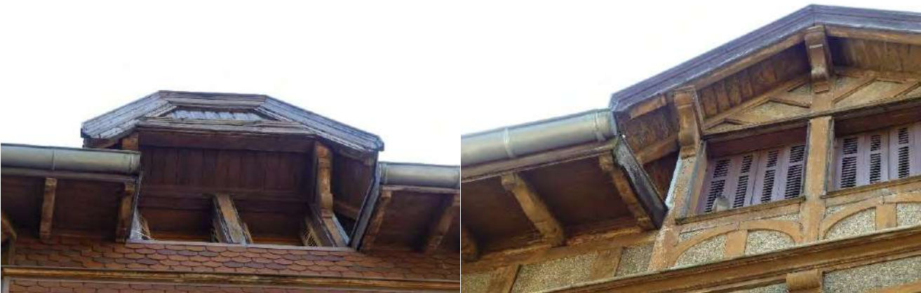
Figure 74 : Bâti favorable aux chiroptères ©EODD, 2024
