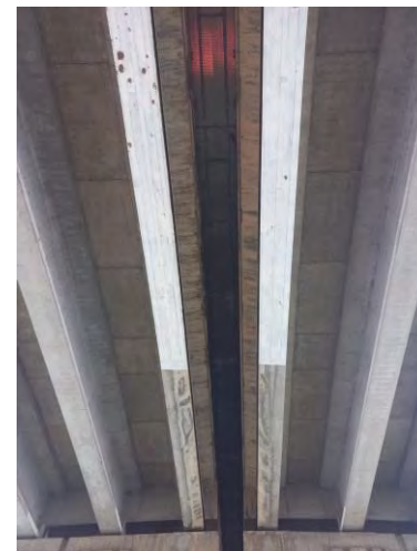
Anfractuosités favorables aux chiroptères dans le pont de la Saône
